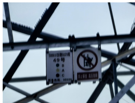
图 5-4 塔基上警示牌
