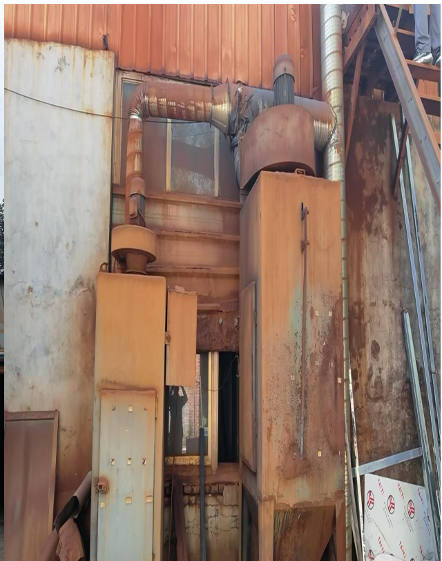
图 4 DA001 环保设施（袋式除尘器）
