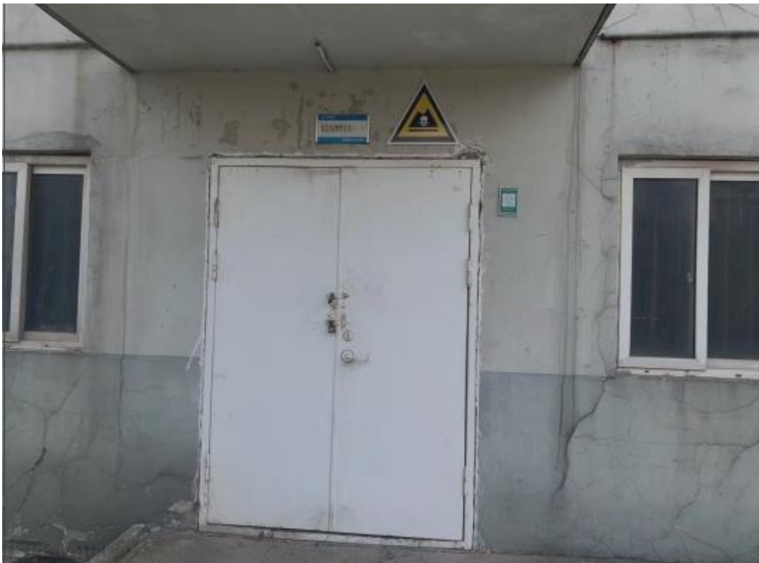
危险废物暂存间
