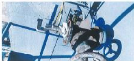
磷酸精制装置尾气排口（O3）
